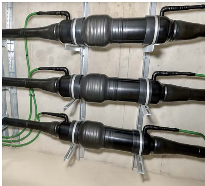
Рис. 3. Муфты транспозиции с выводом экранов одножильными проводами
