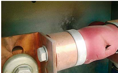
• Фото 2. Последствия установки ОПН 3 кВ в концевой коробке зарубежного производства
