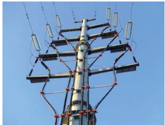
Рис. 7. ПП на многогранной двухцепной опоре ВЛ. Используются сухие гибкие муфты
