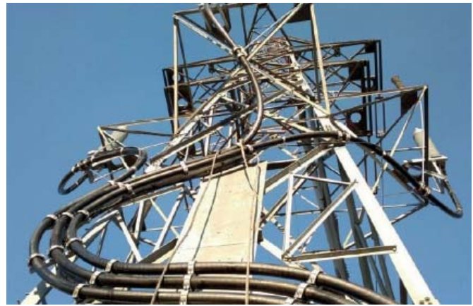
Рис. 10. ПП на решетчатой опоре. Запас кабеля обустроен на теле опоры
