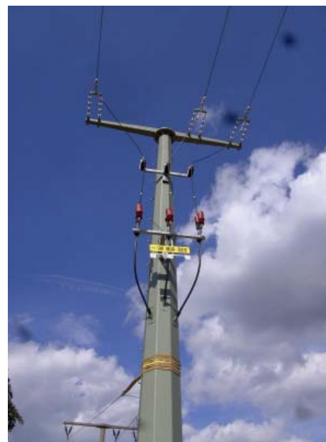
Рис. 9. ПП на многогранной опоре ВЛ. Кабель проходит внутри стойки опоры
