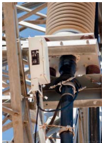
Рис. 13. Измерительная петля оптического ТТ, установленная на кабель под муфтой
