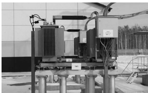
Рис. 11.2. Трансформаторно-преобразовательный блок (ТМП)
